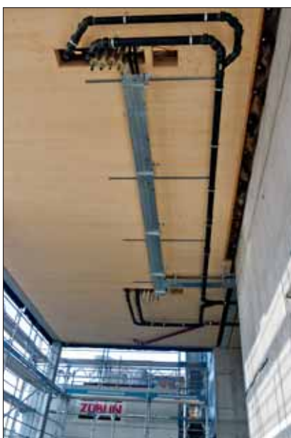
Die Installation wurde an möglichst wenig Stellen konzentriert, um die Zahl der Deckendurchbrüche zu reduzieren.
